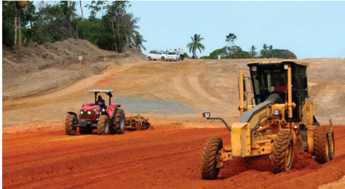
Atualmente, também está sendo construída a Via Metropolitana, uma nova ligação entre a Rodovia CIA-Aeroporto (BA-526) à Estrada do Coco (BA-099), um total de 11,2 quilômetros
